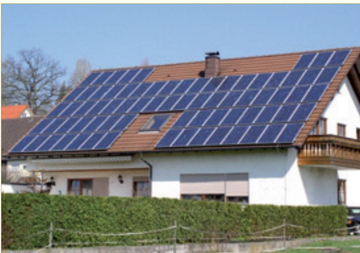
Produzent und Konsument in einem: Wer eine Photovoltaik-Anlage auf seinem Dach installiert hat, ist ein Prosument. (Foto: Stefan Göthert, pixello)
