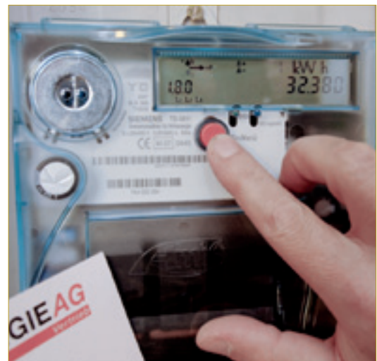
Mit intelligenten Stromzählern können Kunden ihren Stromverbrauch zeitgenau prüfen, steuern und so Kosten senken. (Foto: Siemens)
