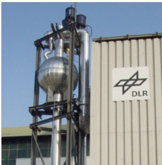
Latentwärmespeicher mit 700-Kilowattstunden-Kapazität für die Speicherung von Dampf bei 100 Bar. (Foto: DLR)
